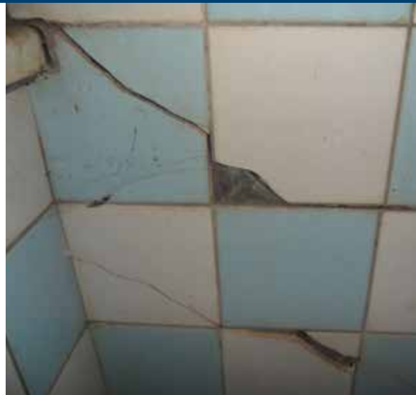
Mange oppdager sprekker i husene sine fra år til år i det sterkt rasutsatte dalføret. FOTO: INGA KHOZREVANIDZE
